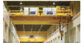
国立研究開発法人日本原子力研究開発機構様納入 130ton×13.5m及65/5ton×13.5m天井クレーン
