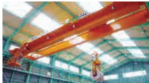
物流センターへ納入 15ton×25mコイルリフター付天井クレーン
